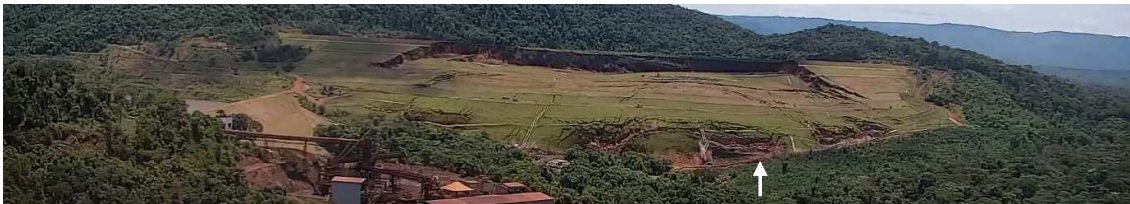
Figura 8: Recalque extenso da crista e abaulamento acima do pé com uma segunda erupção de água na região do abaulamento, a cerca de 5,8 s após a primeira deformação observada na crista
